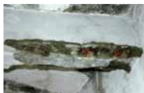
外階段のはり部分の鋪び
