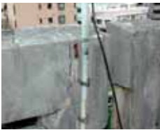
亀裂が入った屋上の手すり
