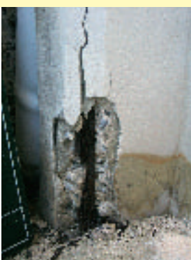
庁舎柱のひび割れ
