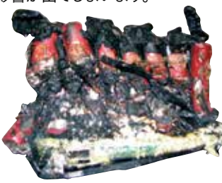
焼け焦げた充電式電池
