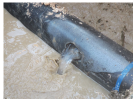
見えない場所で発生する漏水
