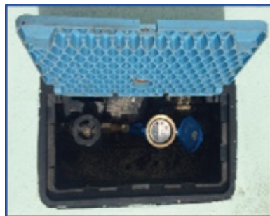
水道メーターボックス
