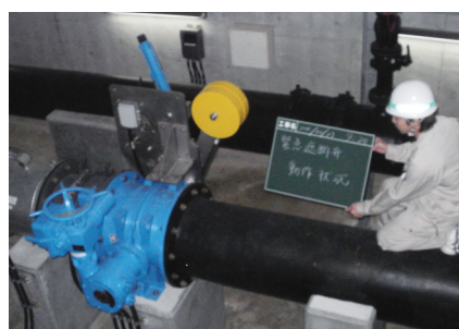
緊急遮断弁確認
