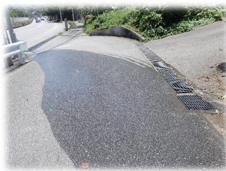
② 漏水により濡れている写真
