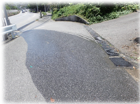
② 漏水により濡れている写真
