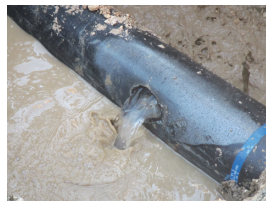
見えない場所で発生する漏水
