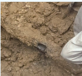
漏れて湧き出す漏水
