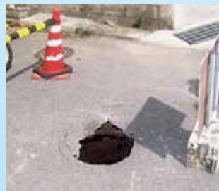
管路破損による道路陥没
