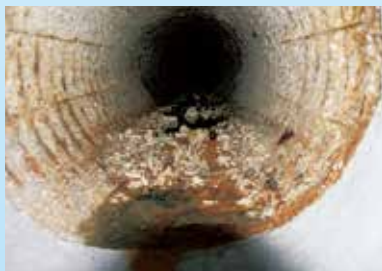
下水道管路の腐食による破損
