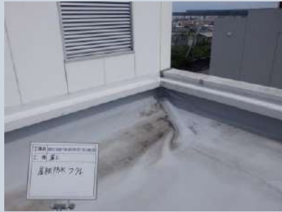
屋上防水のフクレ
