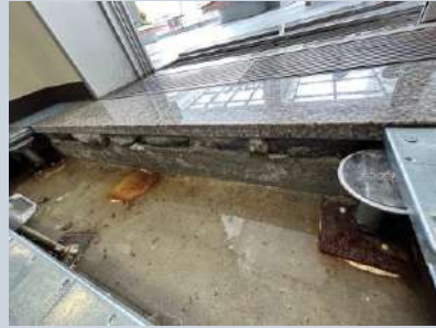
3階排水不良による床下漏水
