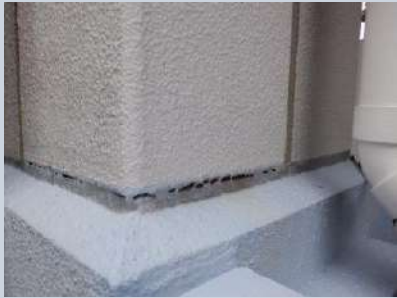
外壁シーリングの劣化
