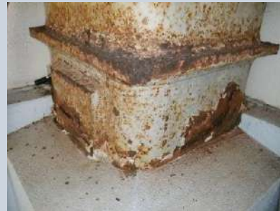
1階ゴミ置場柱腐食
