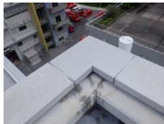
(笠木シーリングの劣化)
