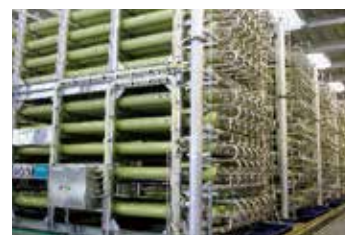
海水淡水化施設内部
