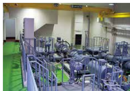
ポンプ場の中
