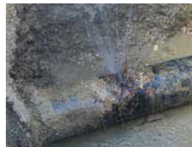
漏れて湧き出す漏水
