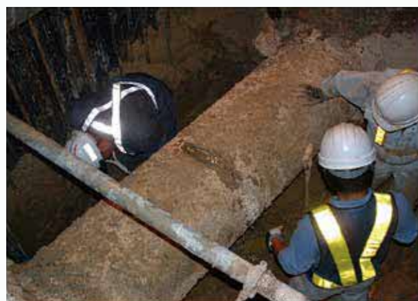
写真 - 耐震性が無い古い水道管
