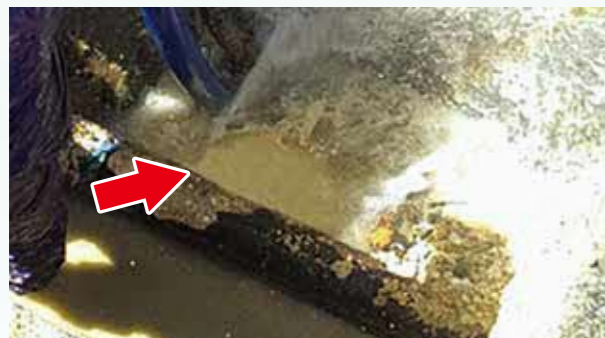
写真 - 古い水道管からの漏水状況
