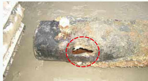
写真 - 古い水道管に開いた穴
