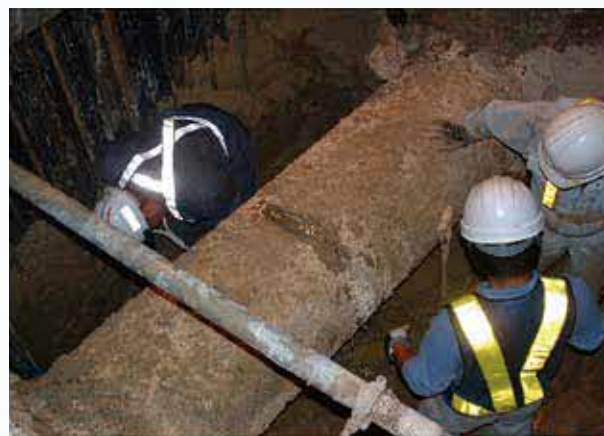
写真 - 耐震性が無い古い水道管
