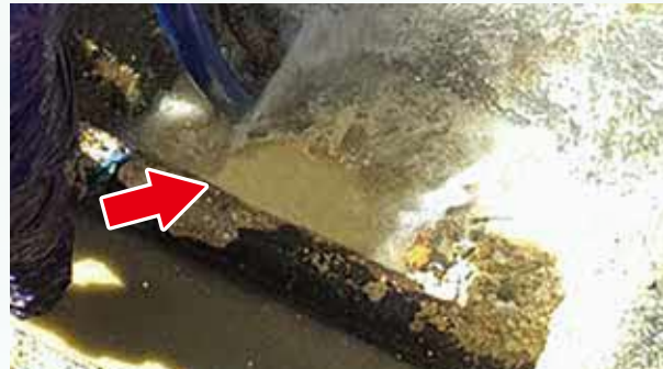
写真 - 古い水道管からの漏水状況
