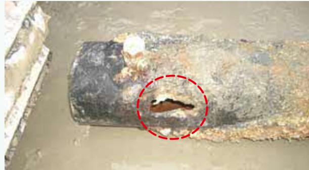
写真 - 古い水道管に開いた穴
