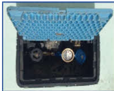
水道メーターボックス
