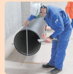
口径 600mm の配水本管
