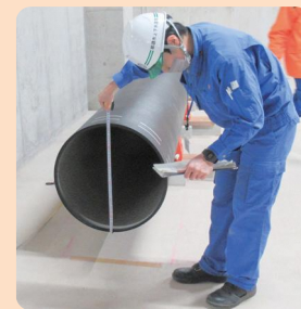
口径 600mm の配水本管
