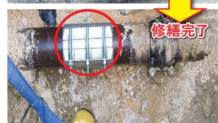
漏れて噴き出す漏水
