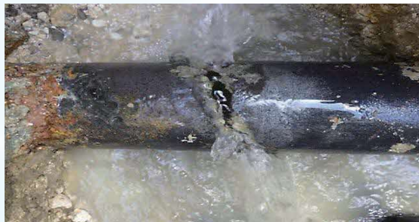
古い水道管からの漏水状況
