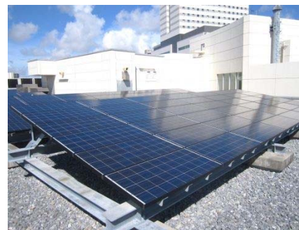
太陽光発電設備
