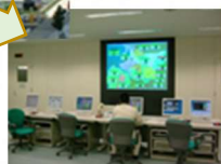
局2F 集中監視センター
