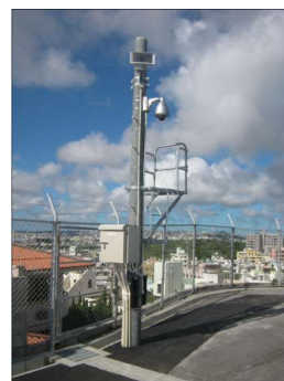
豊見城配水池内の監視カメラ
