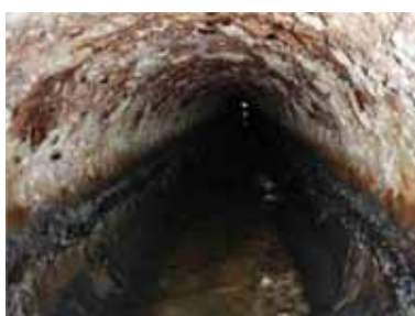
管内の腐食状況
