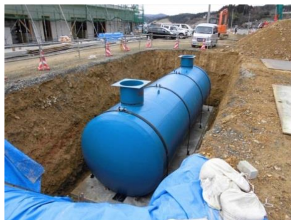
（図4 耐震性貯水槽）
