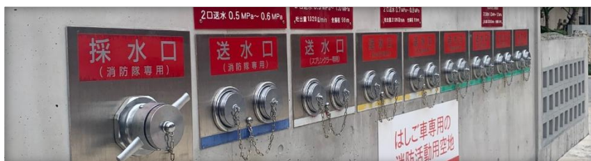
連結送水管・スプリンクラー等の送水口
