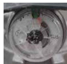
× 指示圧力計の損傷
