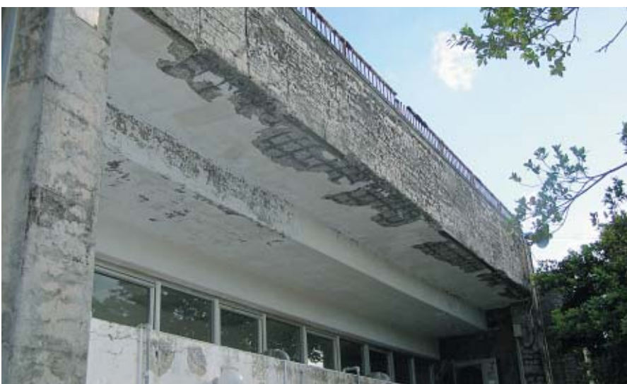
コンクリートのはく離がみられる園舎
