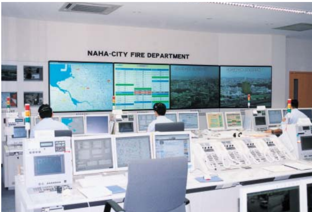
2月10日に本格稼働した消防緊急通信指令システム
