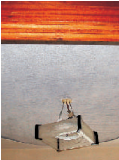
市営住宅天井剥離箇所
