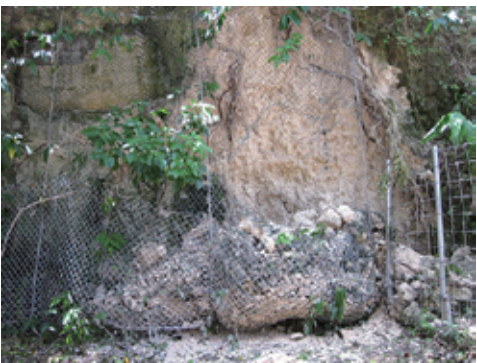
旭ヶ丘公園の崩落現場
