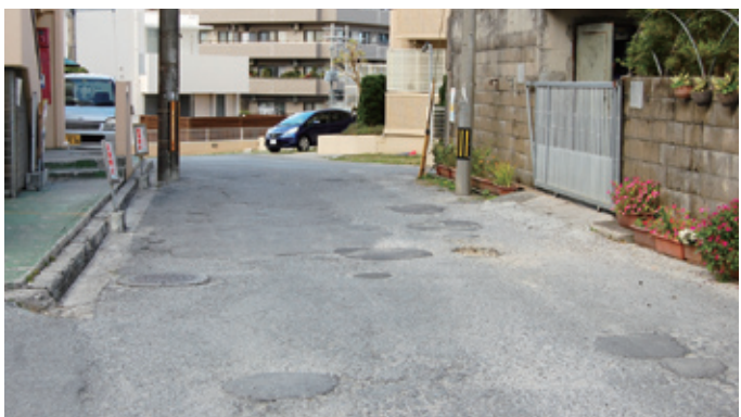
道路補修の要望がある私道通称マンギバル道路
