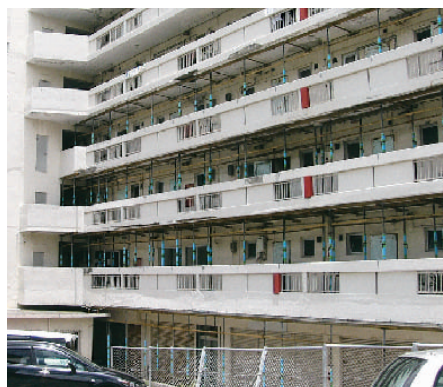
老朽化した古島団地
