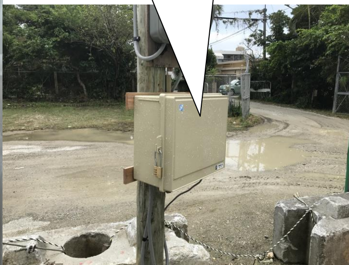
(写真－2 仮設分電盤)
