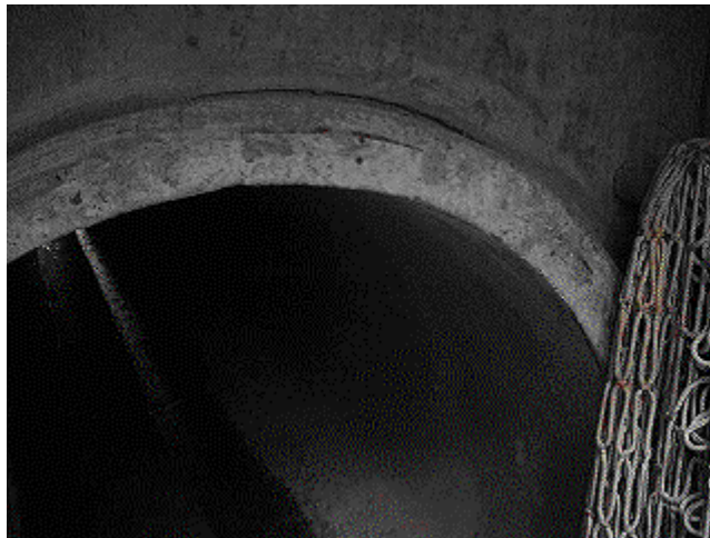
写真 - 7 切管及び管口仕上げ必要
