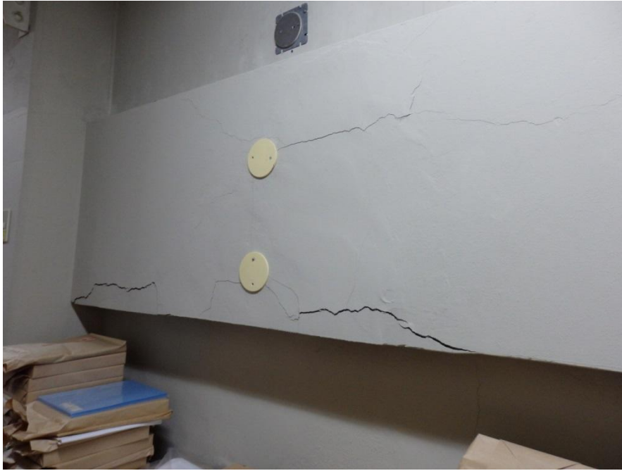
壁面がひび割れている
