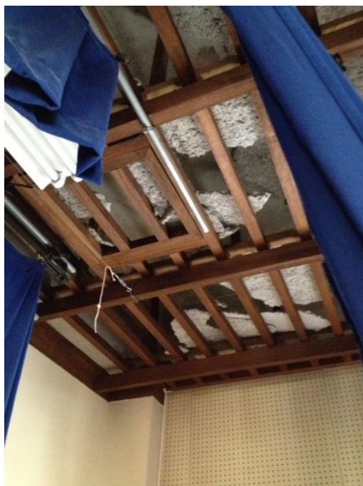
写真は、小禄自治会館内の天井が剥離している様子。
