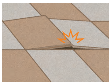
床タイルの浮き
