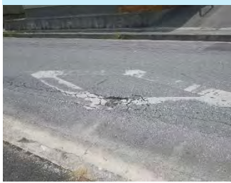
車道にへこみがある
