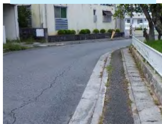
車道にひびが発生
