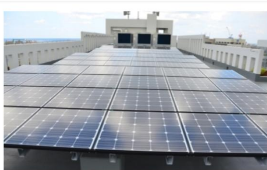
市役所庁舎の屋上に、太陽光発電システムを設置 Intallation of photovoltaic generation system at the roof of Naha city hall
