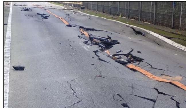
路面の変形（県道14号）
