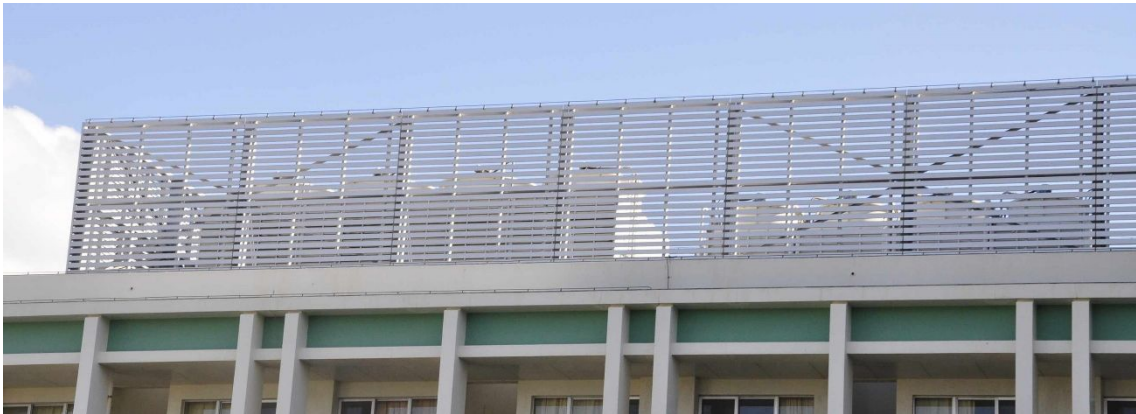
屋外設備をルーバーで目隠している事例【南風原町：沖縄県立南部医療センター・こども医療センター】
