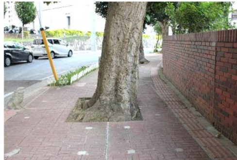
根上がり防止対策を行った事例 【那覇市：開南小学校周辺】
