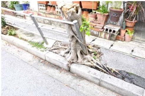
根上がりによる緑石の破損 【那覇市：前島】
