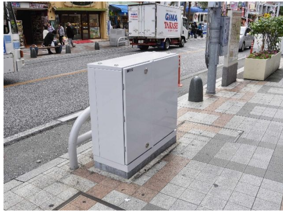
周辺の景観と調和させた電線共同溝 【那覇市：国際通り】
