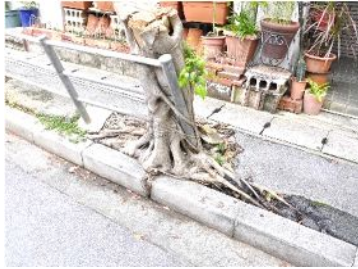
根上りによる歩道の剥離
