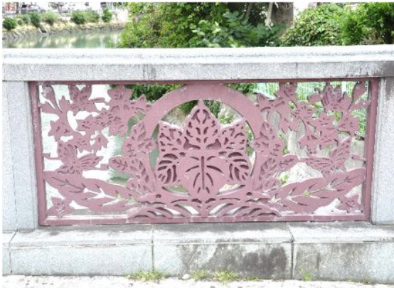
高欄部に那覇の旗頭をデザインした事例 【那覇市：御成橋】
