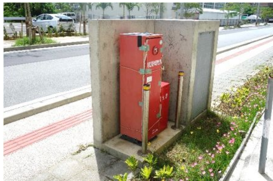
歩道面から消火設備を隠している事例 【那覇市：石嶺市営住宅】
