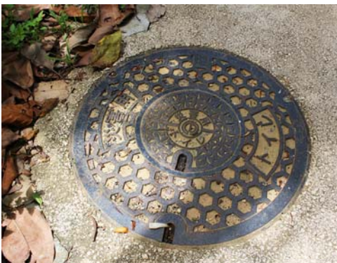
▲ 災害用マンホールトイレ（新都心公園）
