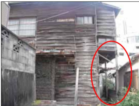
柱の数箇所に破損がある例
