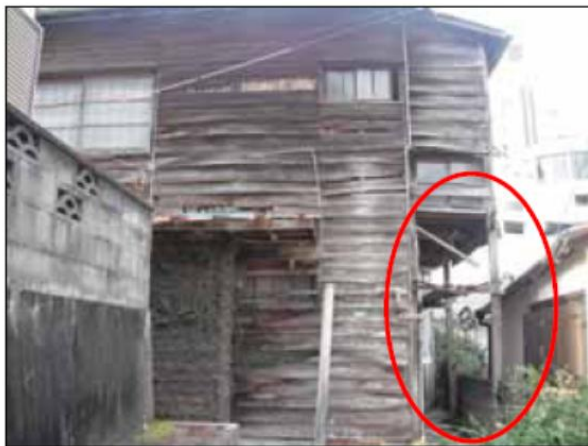
柱の数箇所に破損がある例
