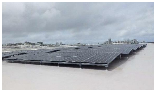
石嶺小学校太陽光発電設備
