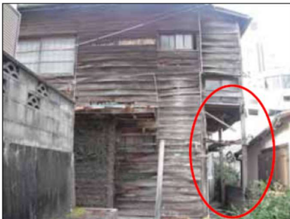
柱の数箇所に破損がある例
